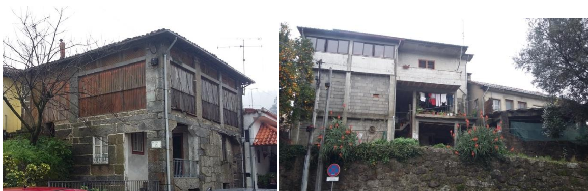
Figura 4. Exemplificação de edifícios bastante degradados no Largo da Eira e Rua do Lagar
