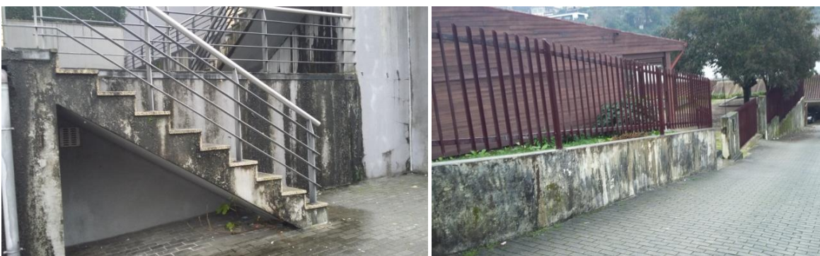
Figura 10. Exemplificação de muros bastante degradados
