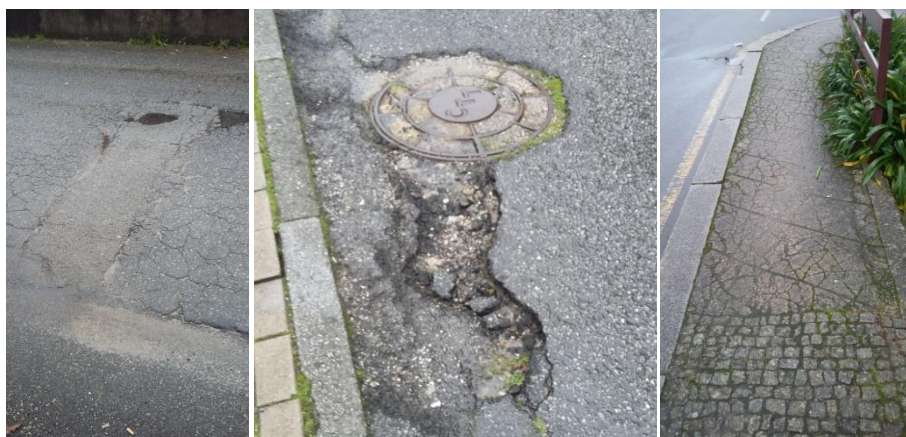
Figura 5. Exemplificação de vias e passeios com o pavimento em mau estado de conservação
