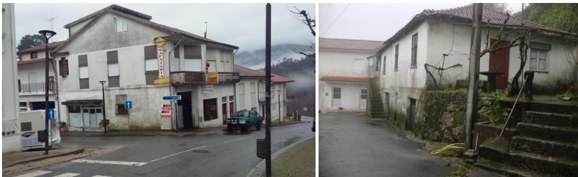
Figura 2. Edifícios degradados na Avenida Paulo Marcelino
